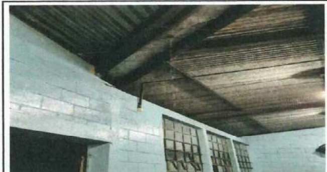
Foto 4: Parte del techo donde se observa como se filtra el agua de los canales.
