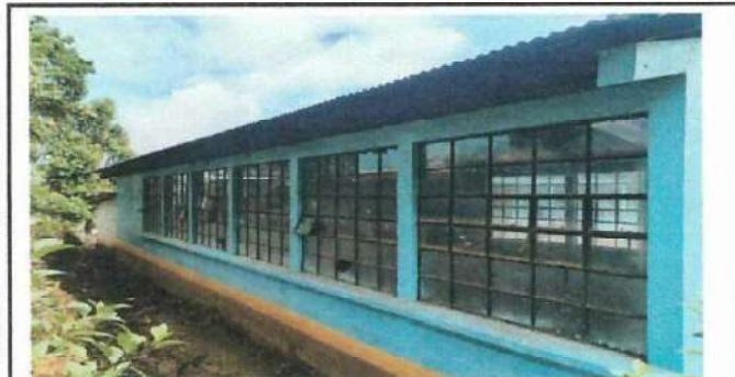
Foto 3: Las ventanas tiene quebrados los vidrios
