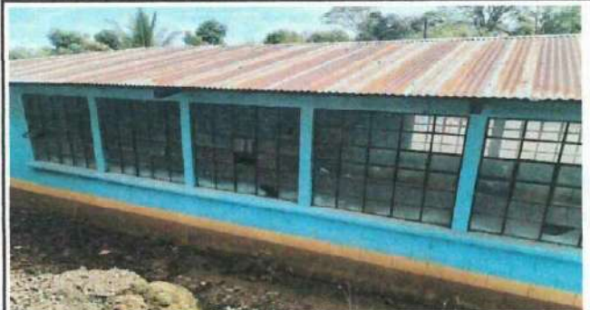
Foto 2: Las laminas de las aulas estan ya deterioradas y esto es un problema durante la temporada de lluvia y los vidrios de las ventanas están quebradas.
