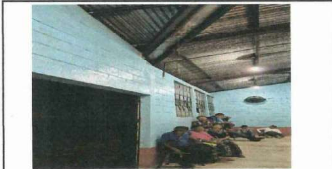
Foto1: El techo del salon de usos multiples esta deteriorado ya que durante la lluvia se filtra el agua.
